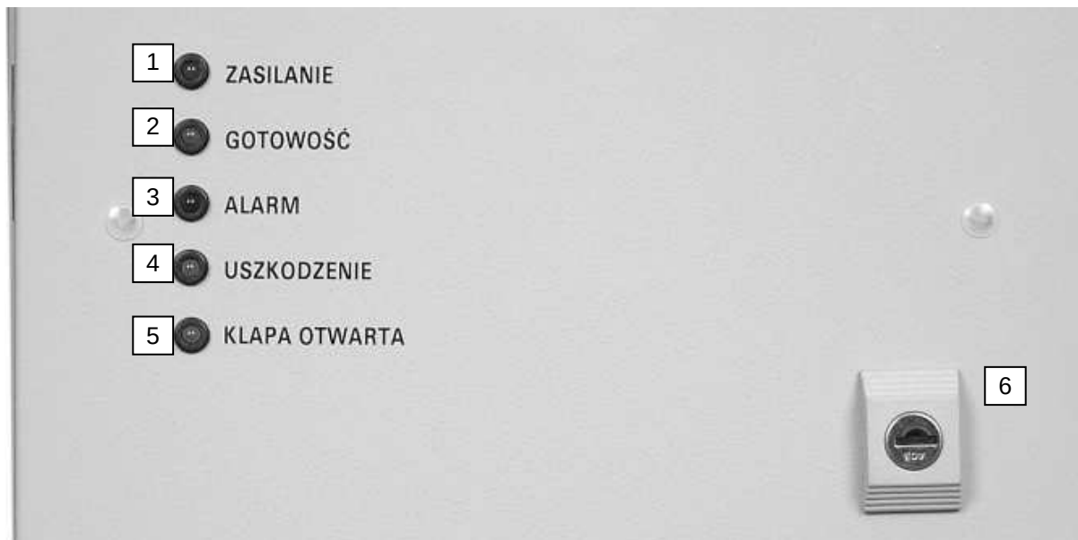
Fot. 1. Płyta czołowa centrali.
